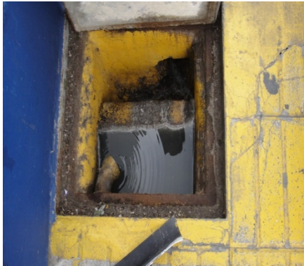
Foto 1. Caja de inspección de agua residual
